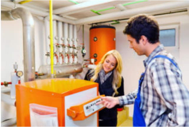
Junger Heizungs Techniker in Heizraum bei Heizanlage
